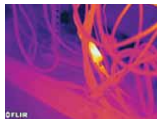
電気設備の不良
